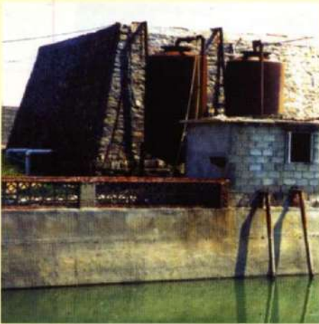
Рис. 205. Комплекс водоподготовки (танк, насосы, фильтры, отстойник)
