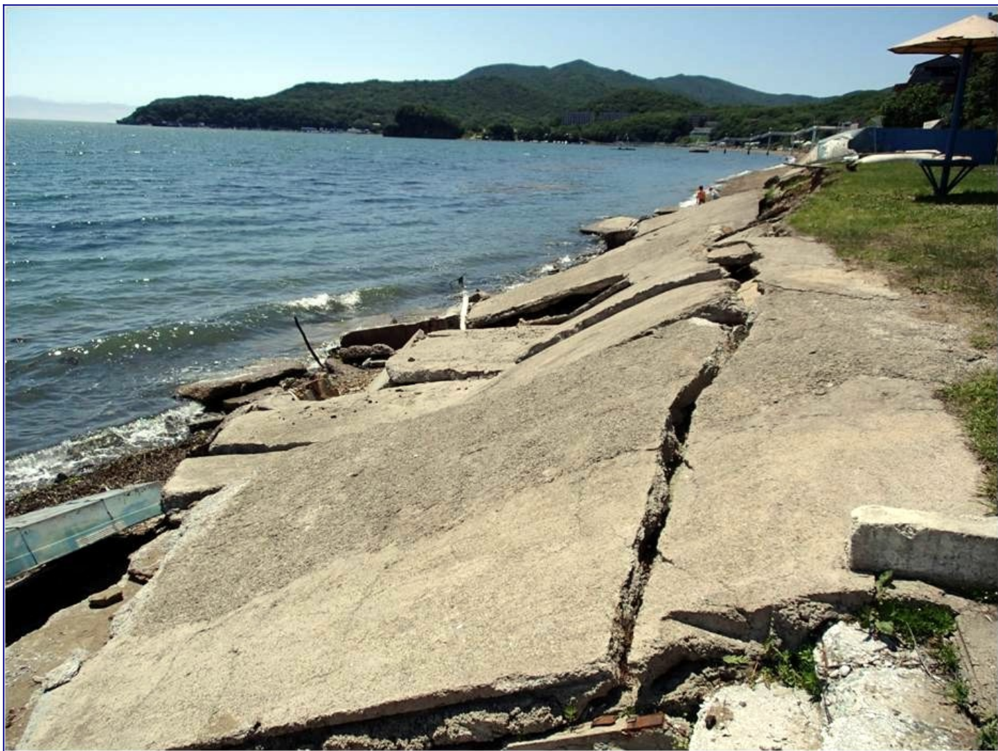
Рис. 5. Вид на аварийное состояние берегозащитных бетонных сооружений (фото В.В. Коробова).
