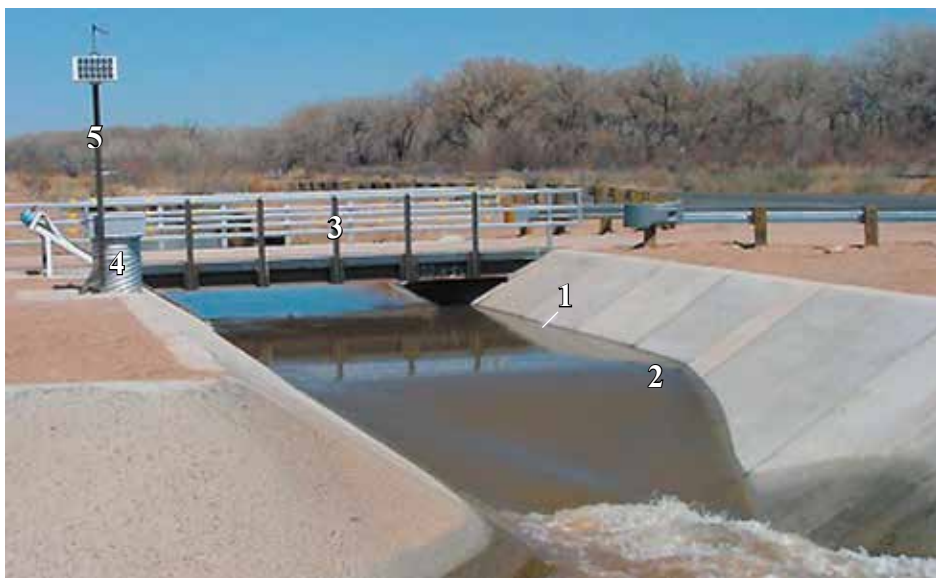
Рис. 1.90. Постоянное гидротехническое сооружение для автоматизированного измерения расхода воды с помощью водослива. Обозначения в тексте. Фото с сайта http://www.intechopen.com
