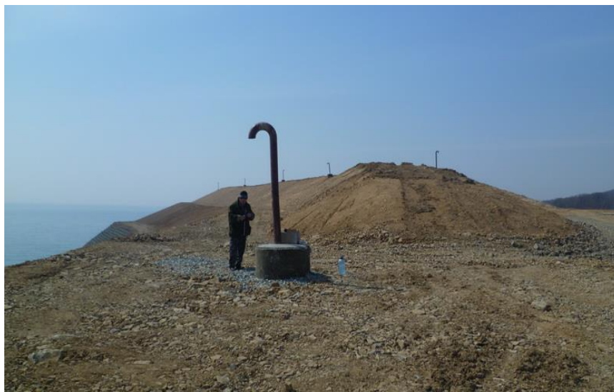
Рис. 4. Газодренажные скважины полигона ТБО, 2011 г. (вид со скв. № 8)
