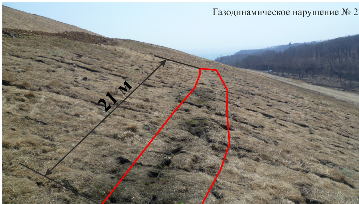
Рис. 8. Газодинамическое нарушение № 2. Западный борт полигона ТБО, 2011 г.
