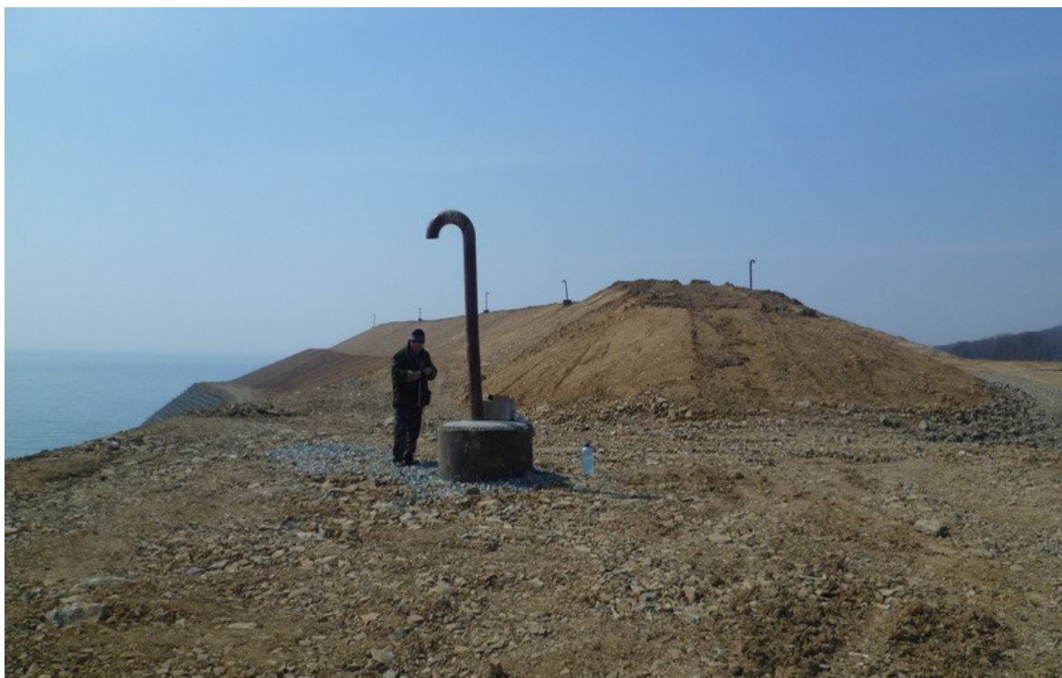
Рис. 3. Газодренажные скважины полигона ТБО, 2011 г. (вид со скв. № 8) Fig. 3. Gas drainage wells on the polygon HCW, 2011 ( appearance from well 8)
